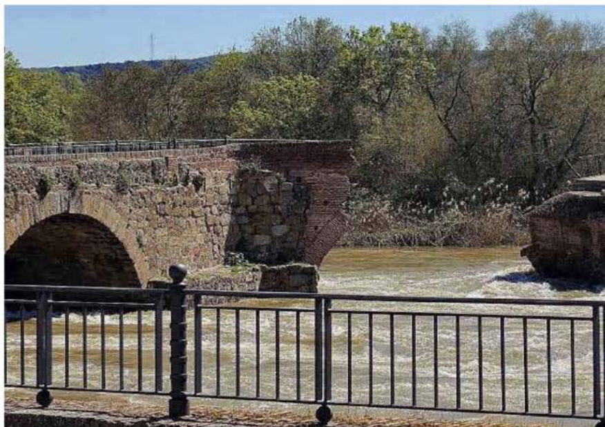
La parte dañada del Puente Viejo este fin de semana; se advierte la bajada de caudal con respecto al día del derrumbe. / MANU REINO
